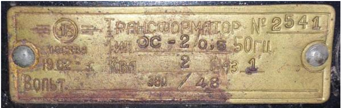
Рисунок 4.8 – Данные трансформатора ОС-2/0,5 №2541
